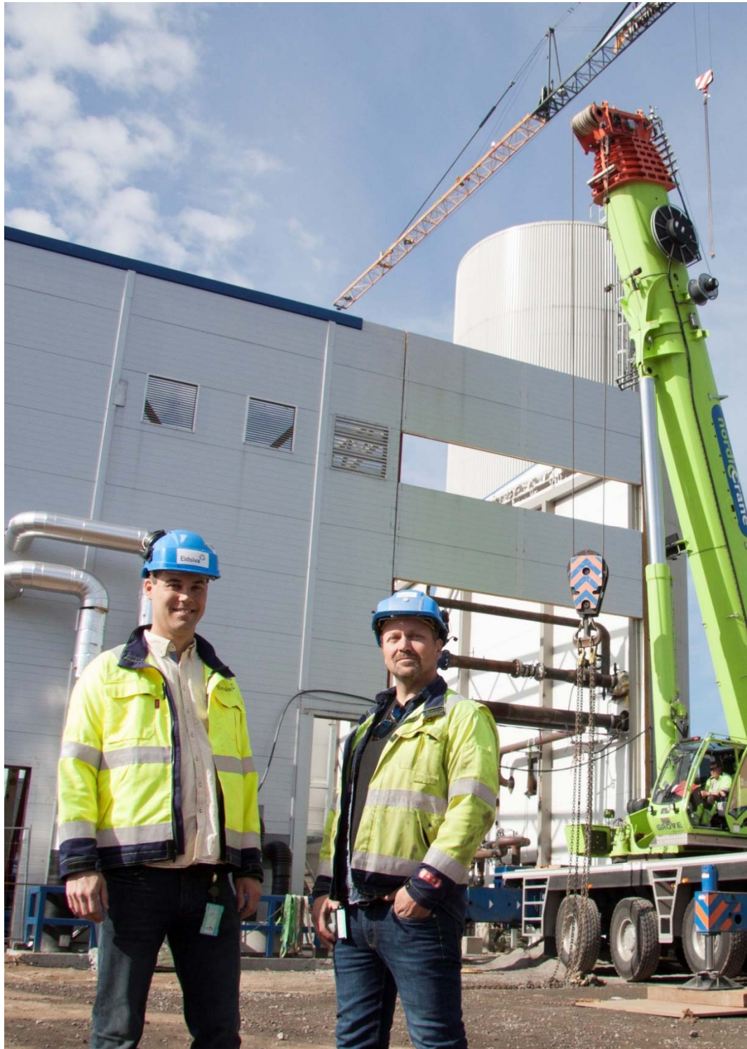
Eidsiva Bioenergi oppgraderer fjernvarmeanlegget i Elverum. Prosjektleder Knut Finstad og driftsleder Roy Arne Hovde.
